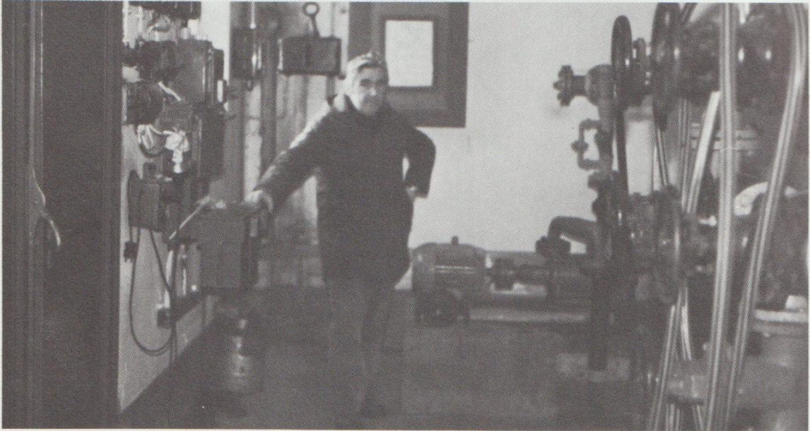
Seit 1964 betreut Gerhard Groß unser Trinkwasser (hier die Pumpstation).
